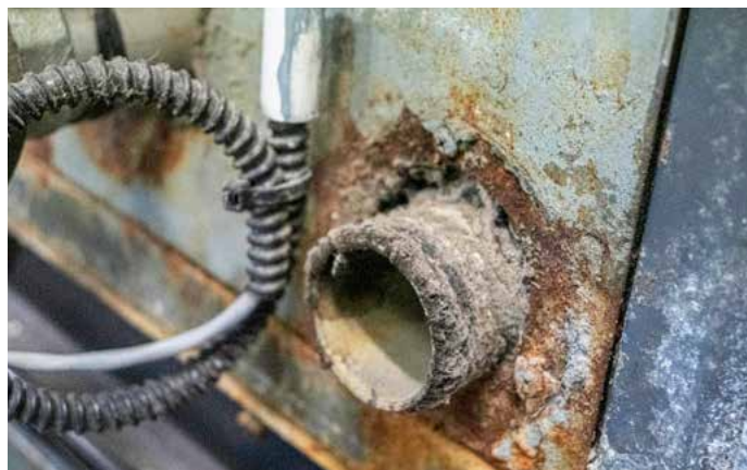
Obecność chloru sprawia, że stalowe elementy infrastruktury basenowej korodują na potęgę i wymagają nieustannej konserwacji.
