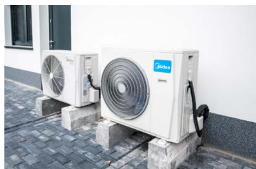
Powietrzna pompa ciepła , która ogrzewa cały budynek za pośrednictwem ogrzewania podłogowego.
