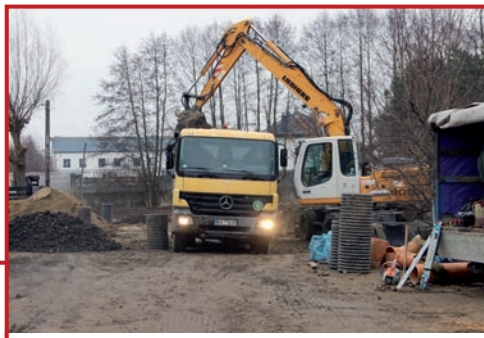
Kanalizacja deszczowa w ulicy Opaczewskiej
