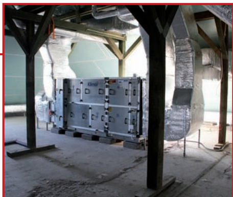
Centrala klimatyzacyjna © J. Kaiper
