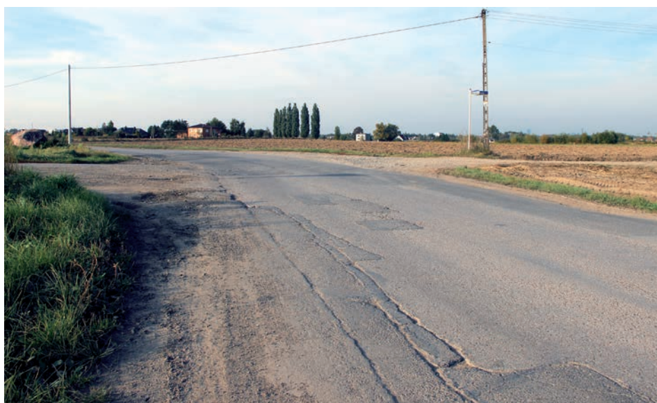
Powiatowa Droga Hrabska do remontu.
